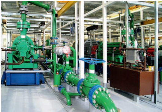
Блочная кустовая насосная станция (БКНС)
