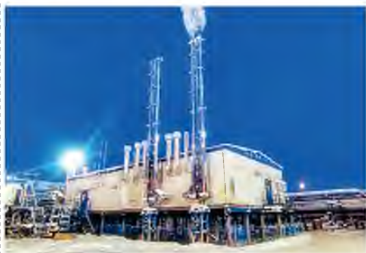
Блок подготовки топливного газа
